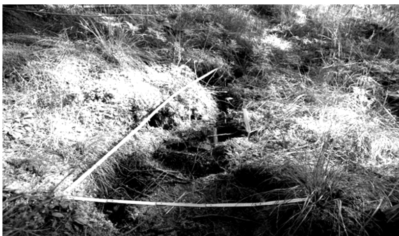
Рис. 2. Тріщини у верхній частині схилу на хр. Озірний.
