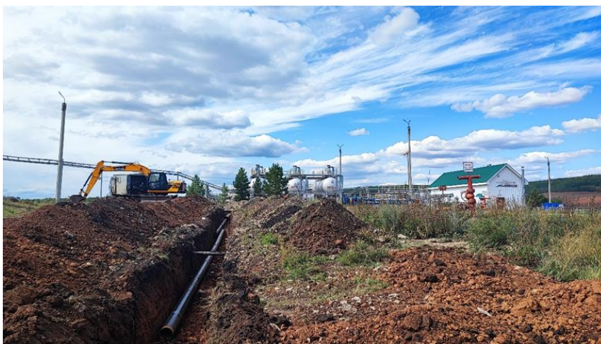
Рис. 1. Прокладка трубопровода для нефтедобывающей организации по элювиальным карбонатно-терригенным породам (фото Гараева А.Н.).
