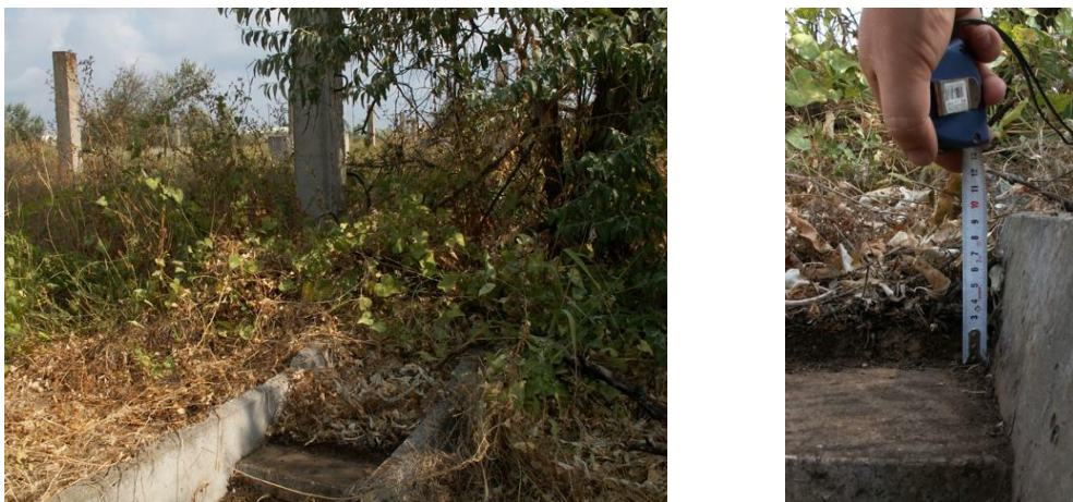
Рис. 3. Почвообразование в бетонных конструкциях на территории заброшенной Крымской солнечной электростанции.
