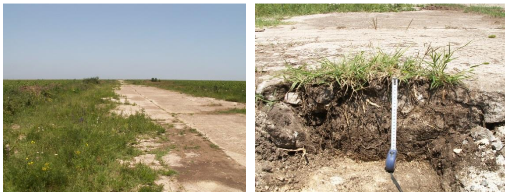
Рис. 4. Почва в стыке бетонных плит аэродрома Багерovo.
